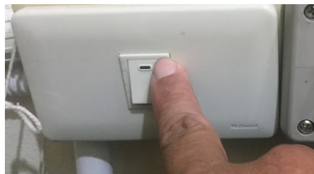
ภาพที่ ๓๔ สวิตช์ On ที่เต้าสวิตช์ เพื่อเปิดกระแสไฟไปยังเครื่องฉาย Projector
