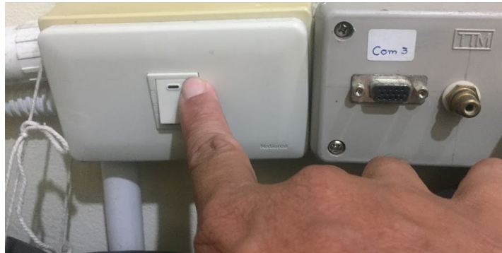
ภาพที่ ๖๘ สวิตช์ On ที่เต้าสวิตช์ เพื่อเปิดกระแสไฟไปยังเครื่องฉาย Projector
