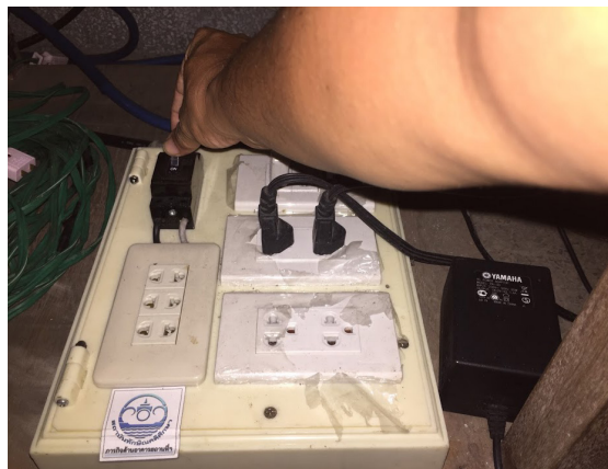
ภาพที่ ๑๘ การเปิดสวิตช์ไฟที่ซูดปลั๊กไฟ
